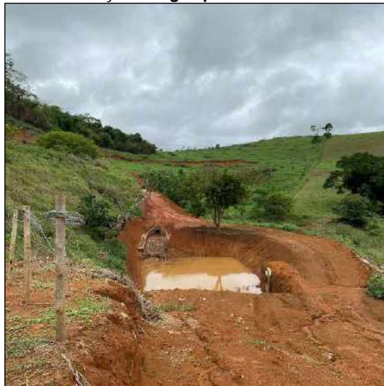
Figura 21 – Bacia de retenção de água pluvial do Aterro Sanitário de Muriaé.
