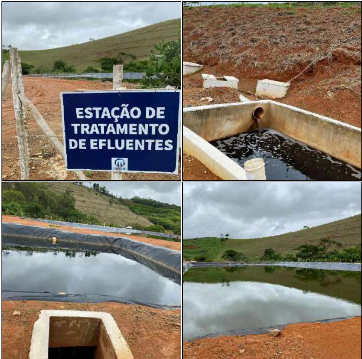
Figura 22 – Estação de Tratamento de Líquidos Percolados do Aterro Sanitário de Muriaé.
