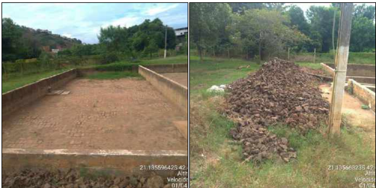
Figura 52 – Leito de secagem e acondicionamento do lodo seco na ETE José Cirilo.
