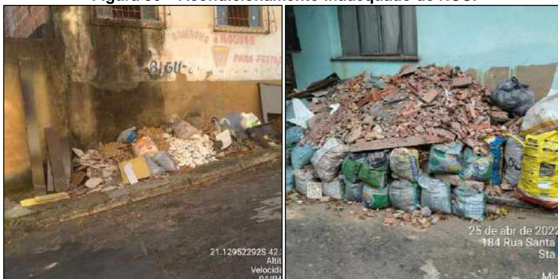
Figura 56 – Acondicionamento inadequado de RCC.
