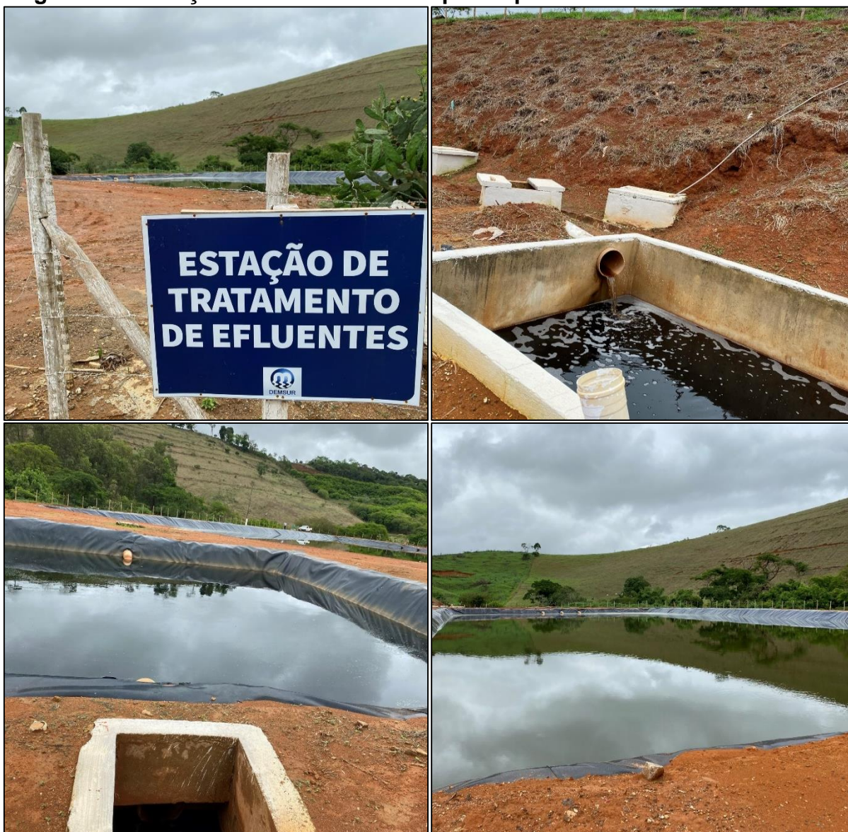
Figura 26 – Estação de tratamento de líquidos percolados do aterro sanitário.
