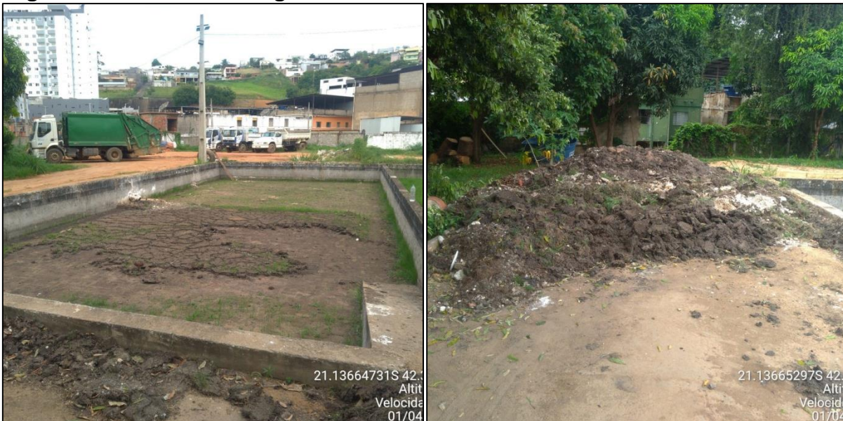
Figura 54 – Leito de secagem e acondicionamento do lodo seco na ETE Safira.
