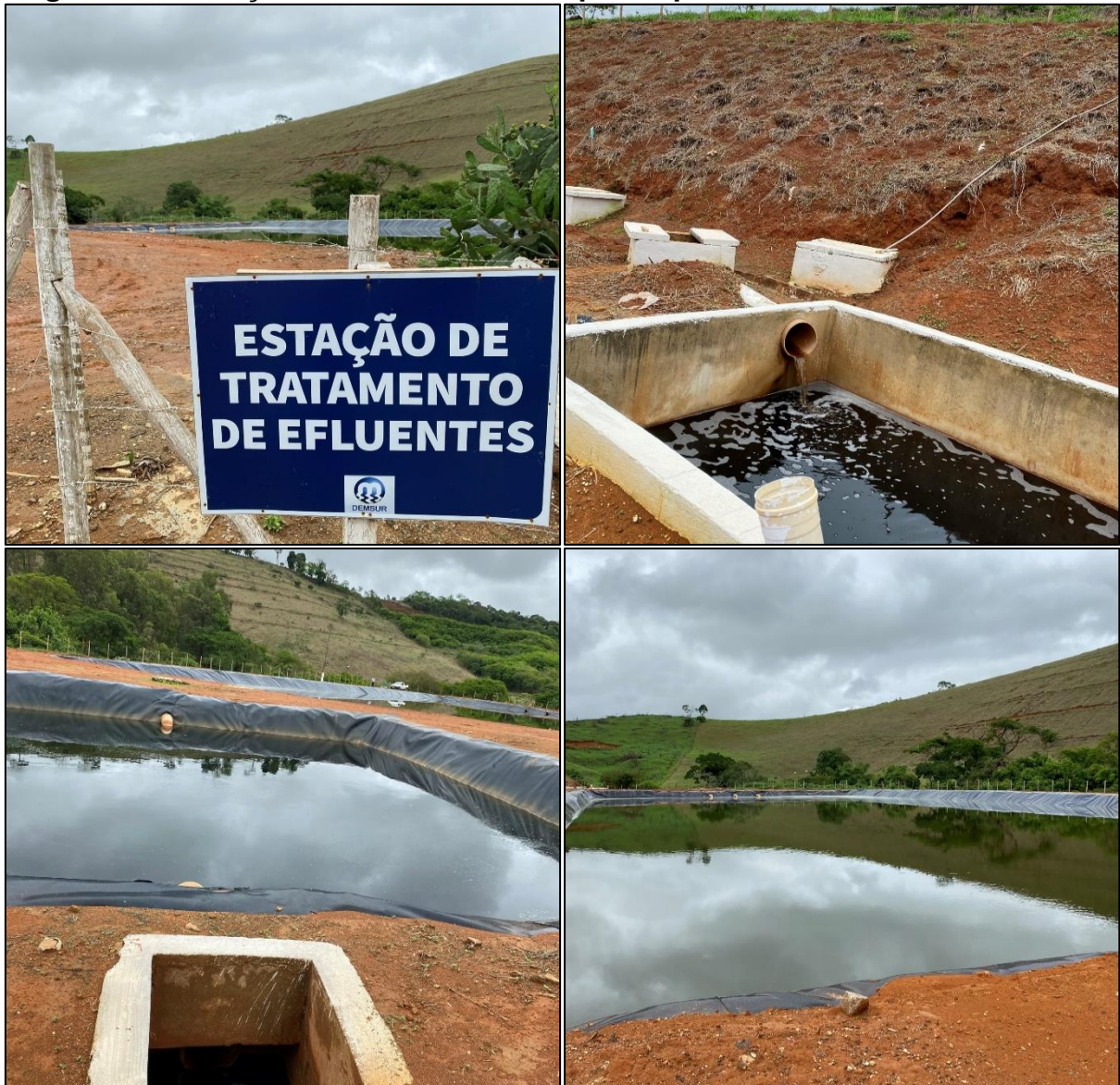
Figura 26 – Estação de tratamento de líquidos percolados do aterro sanitário.
