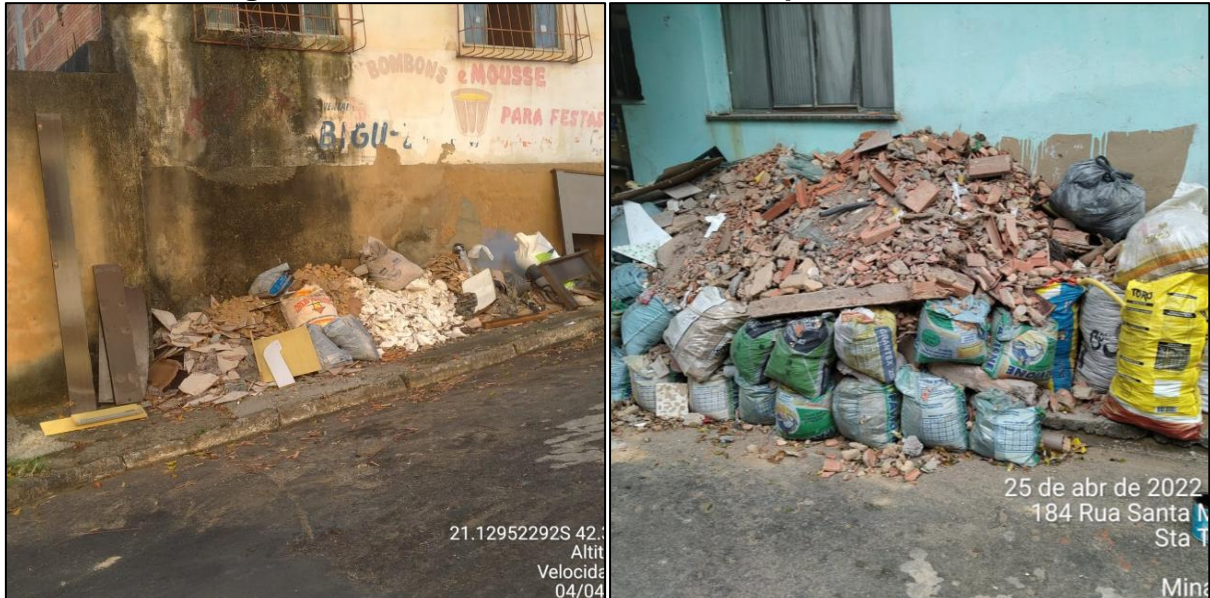
Figura 71 – Acondicionamento inadequado de RCC.
